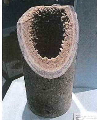
Asbestvezel in leiding
